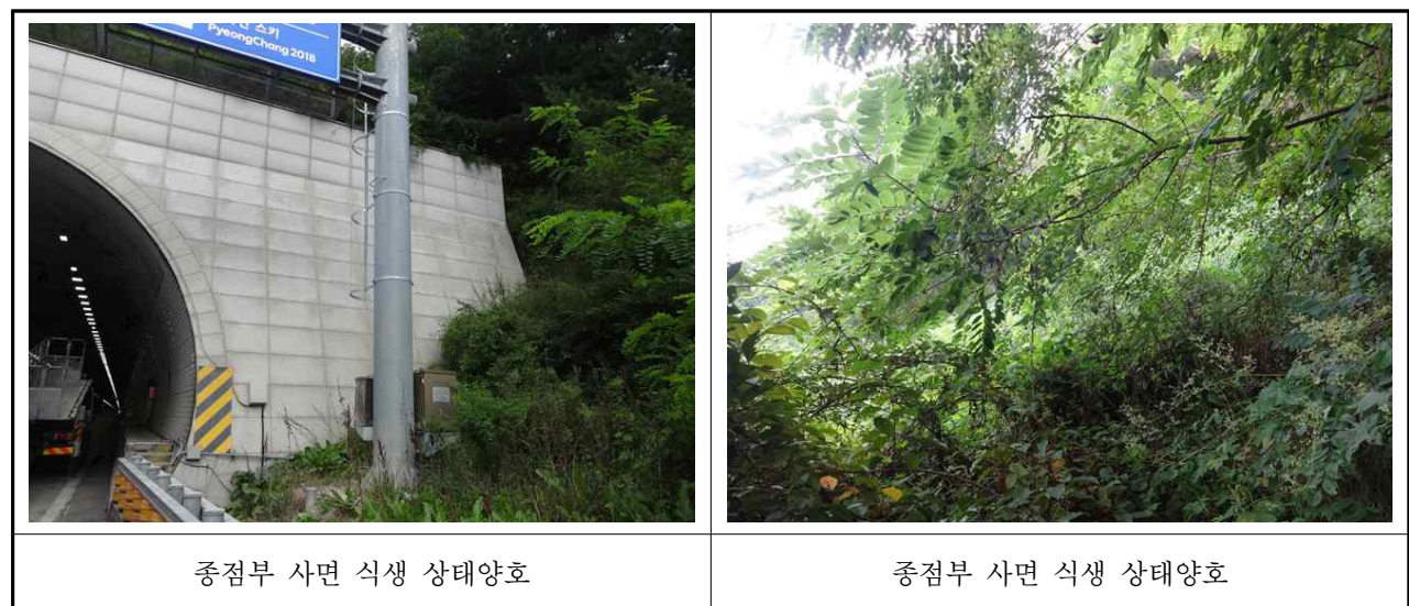
【사진 3.10】 사면 손상현황
